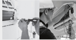
Raccordement électrique difficile
